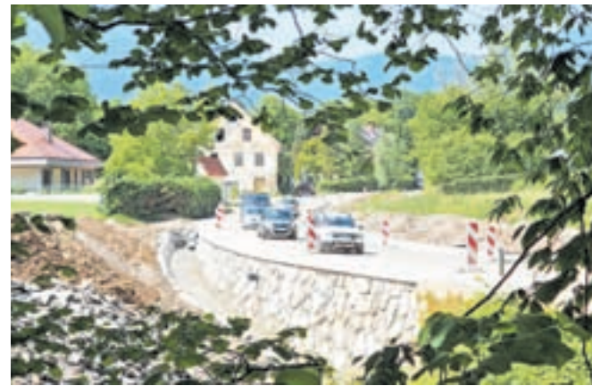
V Zadragi je šlo za zahtevno gradnjo kanalizacije, cesto pa že asfaltirajo. / FOTO: IVAN MEGLIČ
